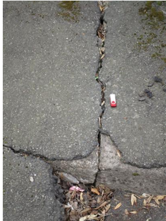
Ansicht 16: Risse in der Fahrbahndecke 89
