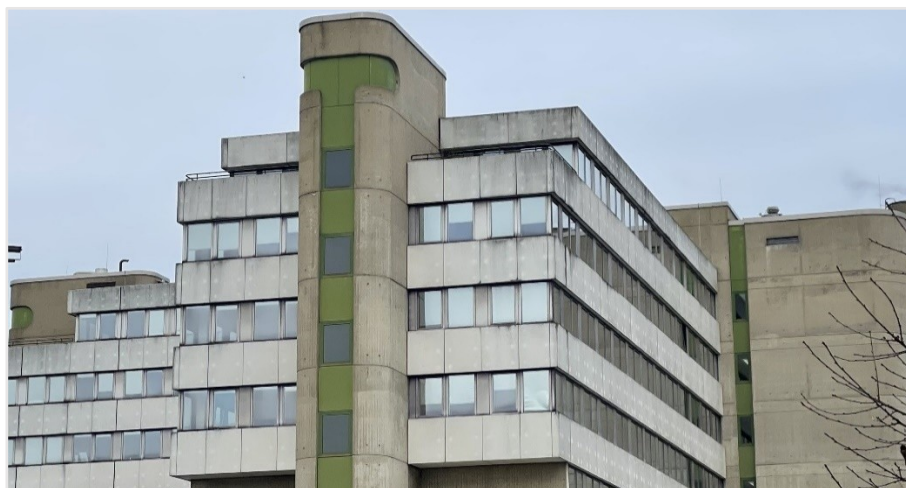
Abbildung 24: Sanierungsbedürftiges FA Hannover-Land I (Quelle: LRH)
